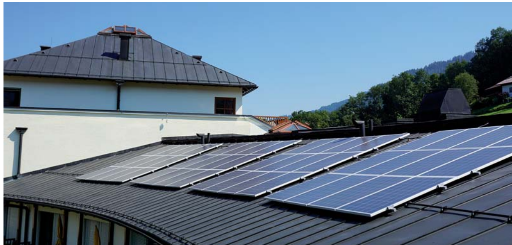
2015 wurde auf dem Dach des Seniorenheimes eine PV-Anlage installiert, der daraus gewonnene Strom wird auch für den Eigenverbrauch verwendet. Foto: E. Viehhauser
